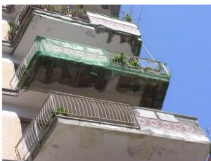
Balconi in attesa di decidere l'intervento di risanamento
